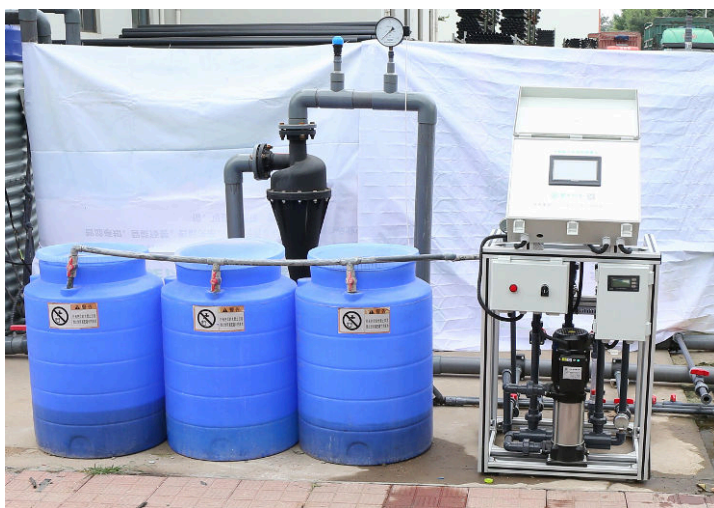
8GGSBD-32Z 型灌溉首部
